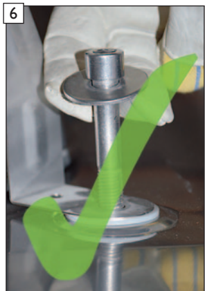
Richtige Reihenfolge: 1. Silikondichtung 2. Regenhaube „EAGLE“ 3. Edelstahl-Unterlegscheibe 4. Edelstahl-Inbusschraube M12
