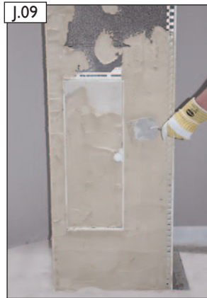
J.09 Anbringen des bauseitigen Unterputzes auf den Design-Fertigfuß und den Putzträger der BlowerDoor Design-Tür.
